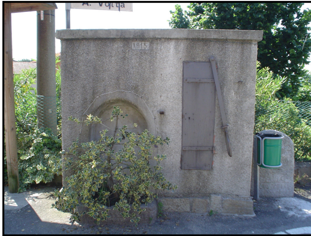
Figura 5.21: Foto pompa dell'acqua
